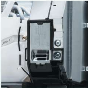
รับประกันการใช้งานที่วางใจได้ และการป้องกันอุบัติเหตุไฟไหม้ ในกรณีไฟฟ้าลัดวงจร
